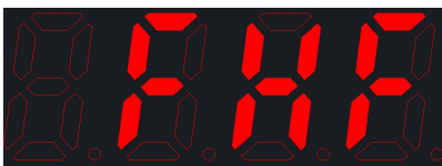
防火阀故障(信号被配置时需短接) 故障代号显示:
