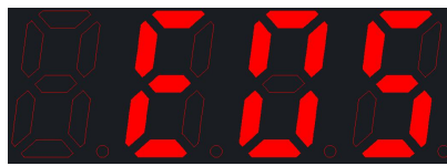
故障代号显示(外部电源故障)
