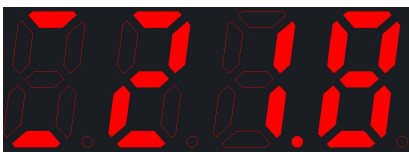
2#水泵电流值（单位：A）
